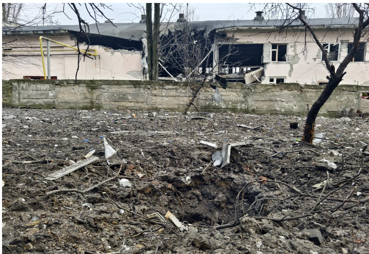
Рис. 6 - Попадание № 5: в здание цеха металлообработки по адресу улица Артёма, д. 169М.
