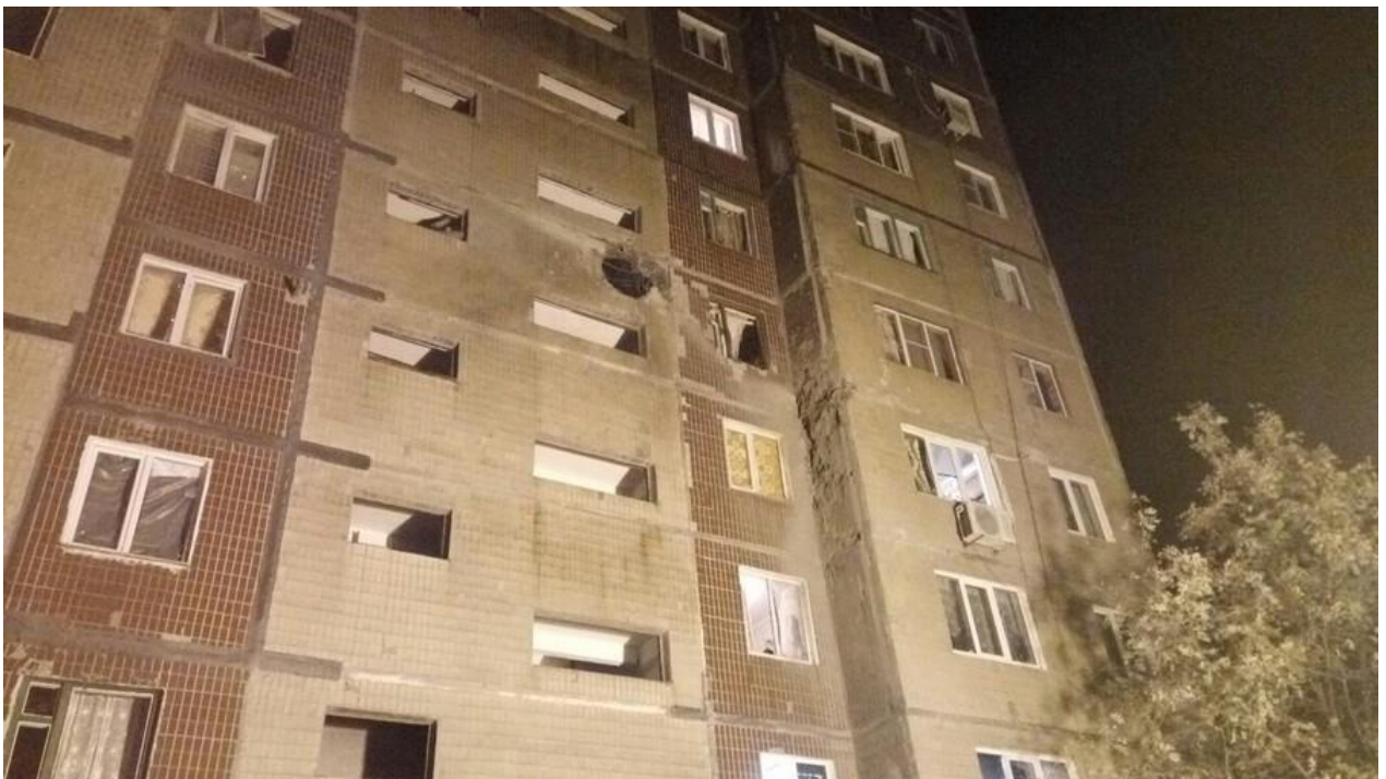
Рис. 7 – Следы от попадания в здание по адресу: квартал Строитель, д10.
