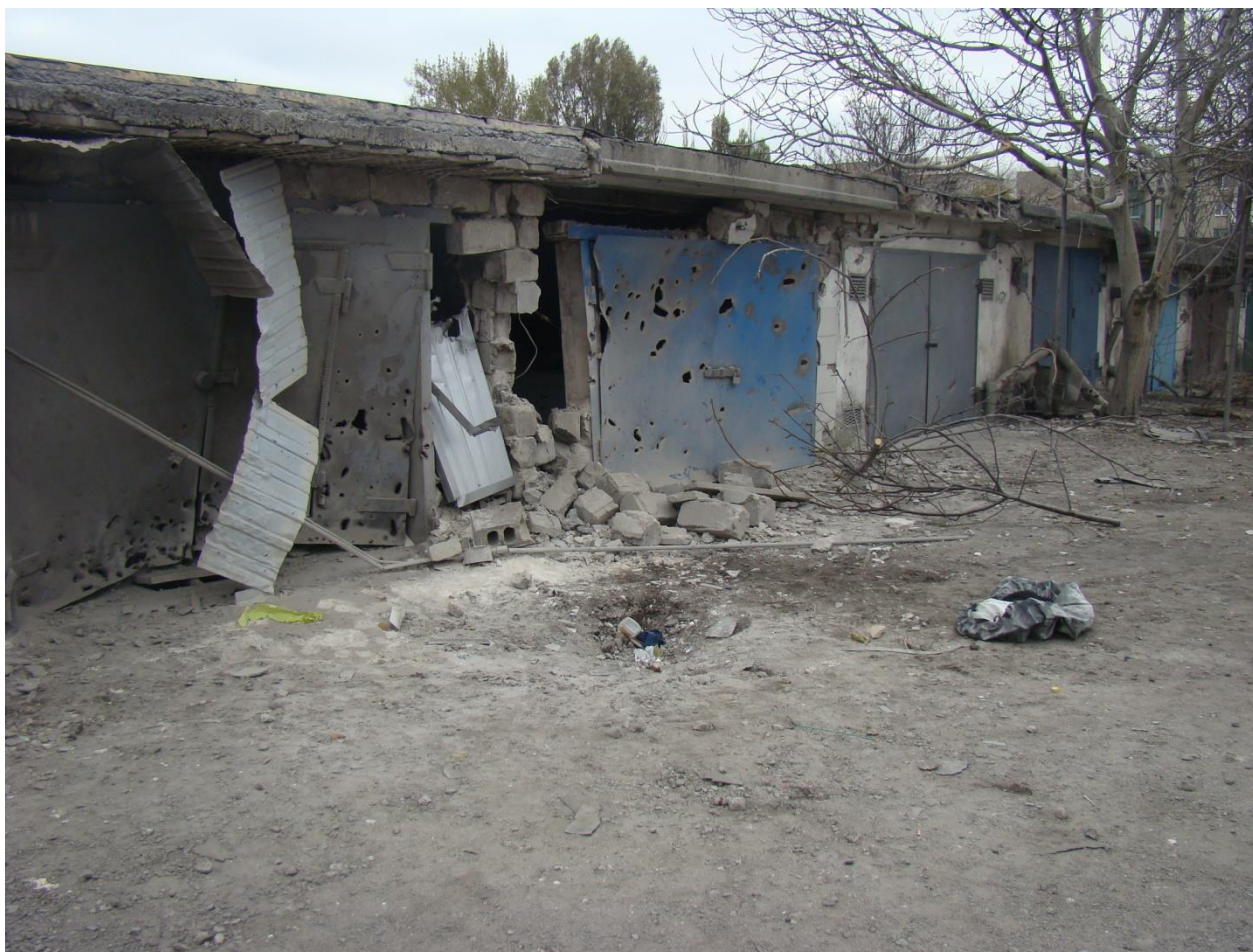
Рис. 6 – Следы от попадания на территории гаражного кооператива «Дружба».
