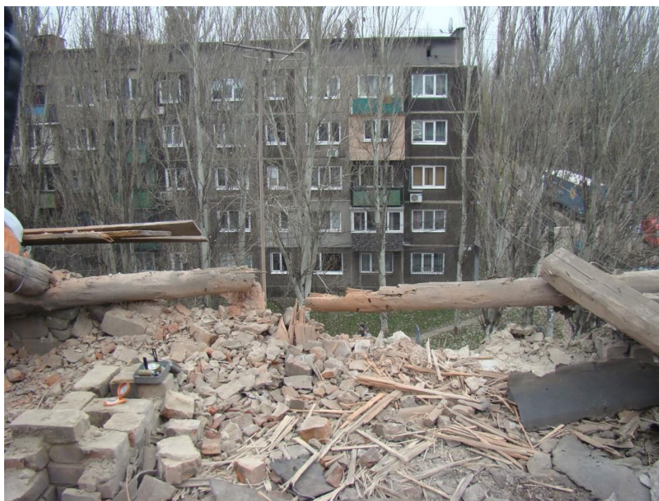
Рис. 9 – Повреждения крыши дома № 40/73 по ул. Героев Сталинграда в г. Макеевка.
