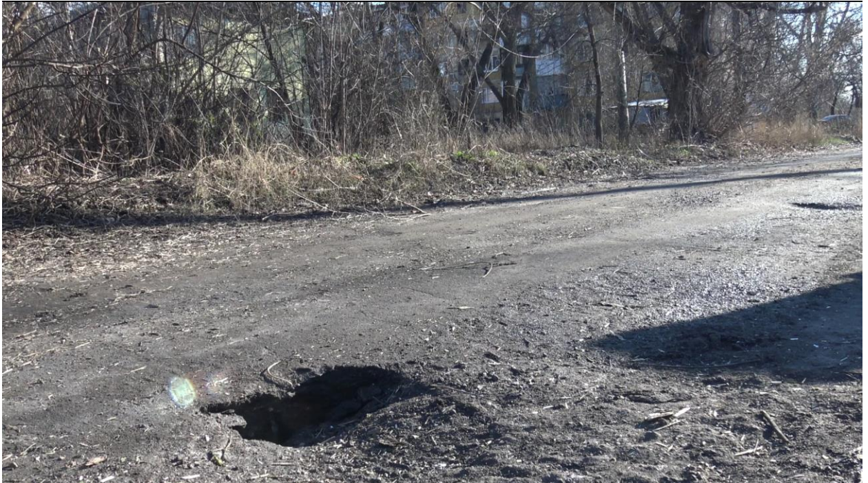
Рис. 9 - Воронка на асфальтовом покрытии дороги по ул. Семёна Тяньшанского.
