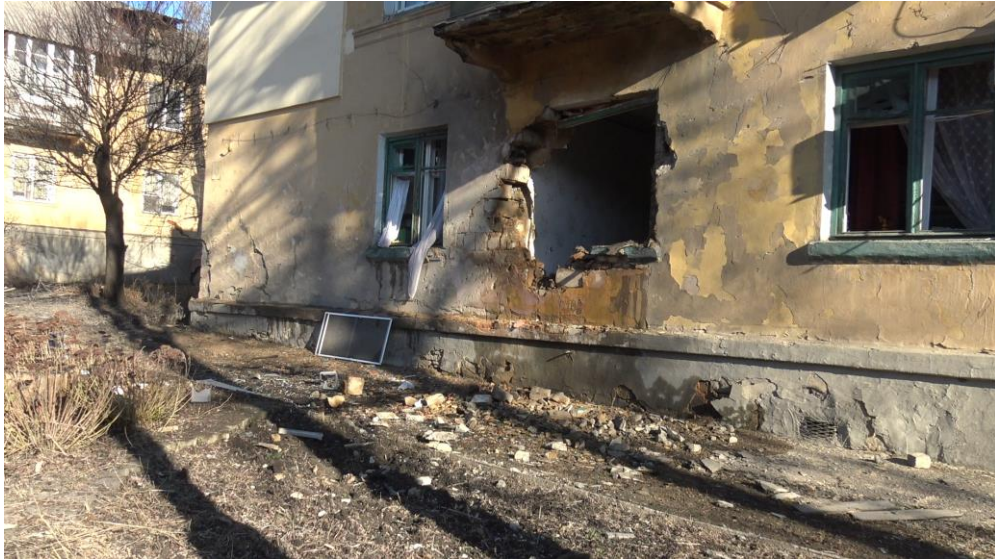
Рис. 4 - Следы от попадания реактивного снаряда в жилой дом по адресу ул. Семёнова-Тянь-Шанского, д. 3.
