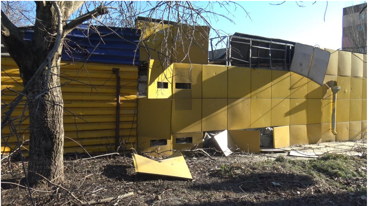
Рис. 3 - Разрушения крыши магазина «Петрович» вид с улицы.
