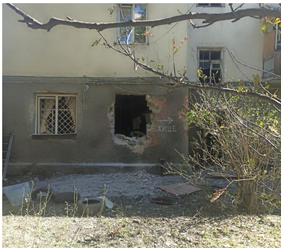
Рис. 3 – След детонации на уровне окна первого этажа дома по адресу г. Донецк, ул. Александра Матросова, д. 1 34 .
