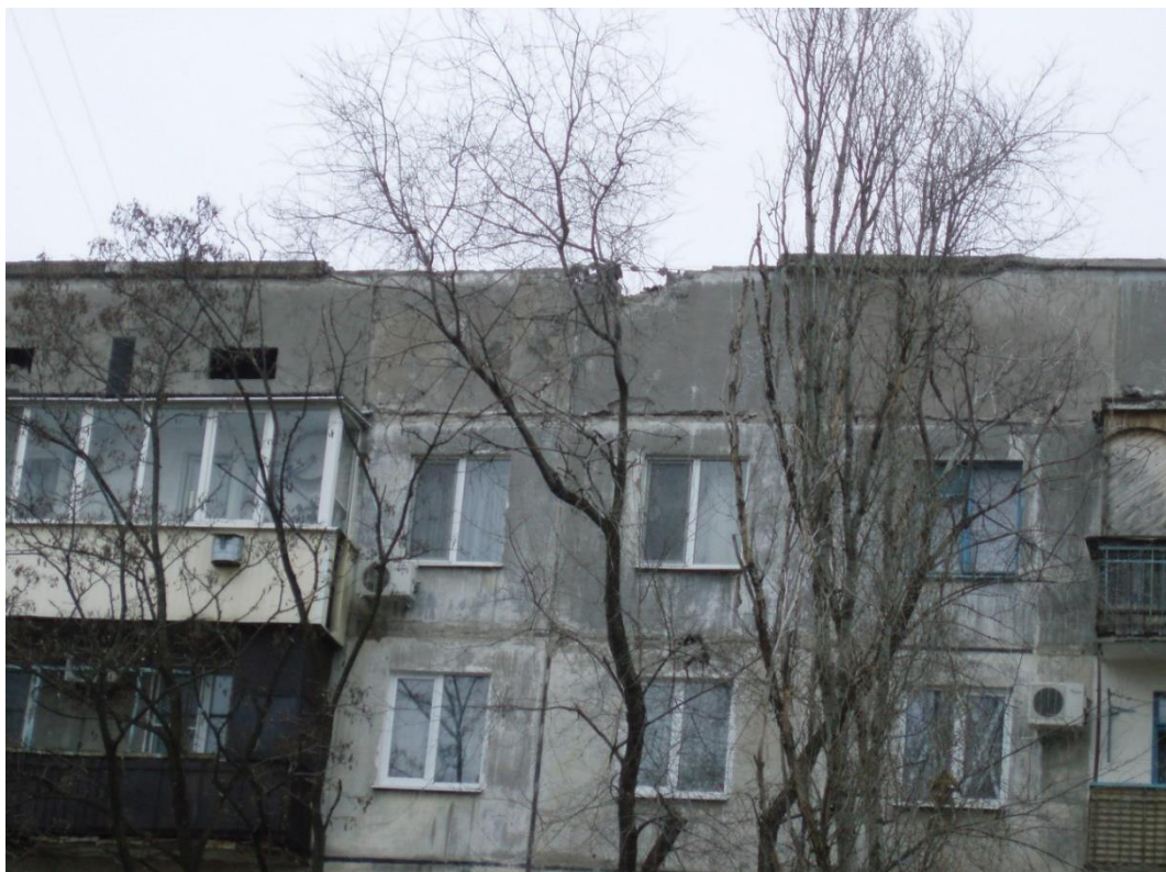
Рис. 6 – Крыша, поврежденная в результате попадания №3 27 .
