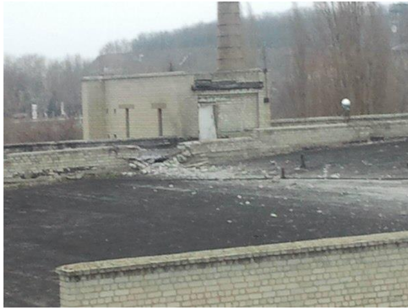
Рис. 15 - Крыша техникума, поврежденная в результате попадания №7 34 .
