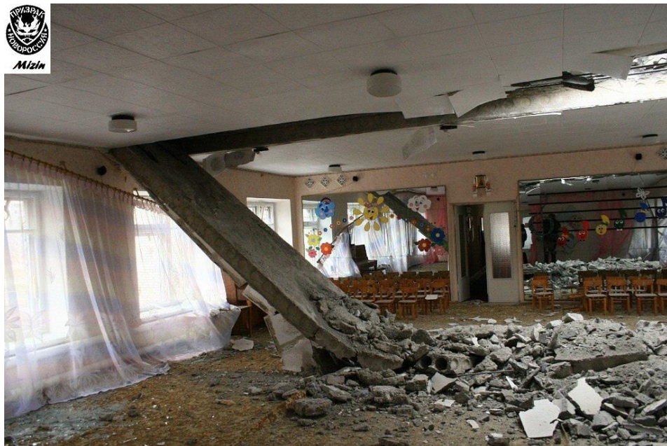
Рис. 4 -Перекрытия музыкального зала детского сада, обрушившиеся в результате попадания №2 26 .
