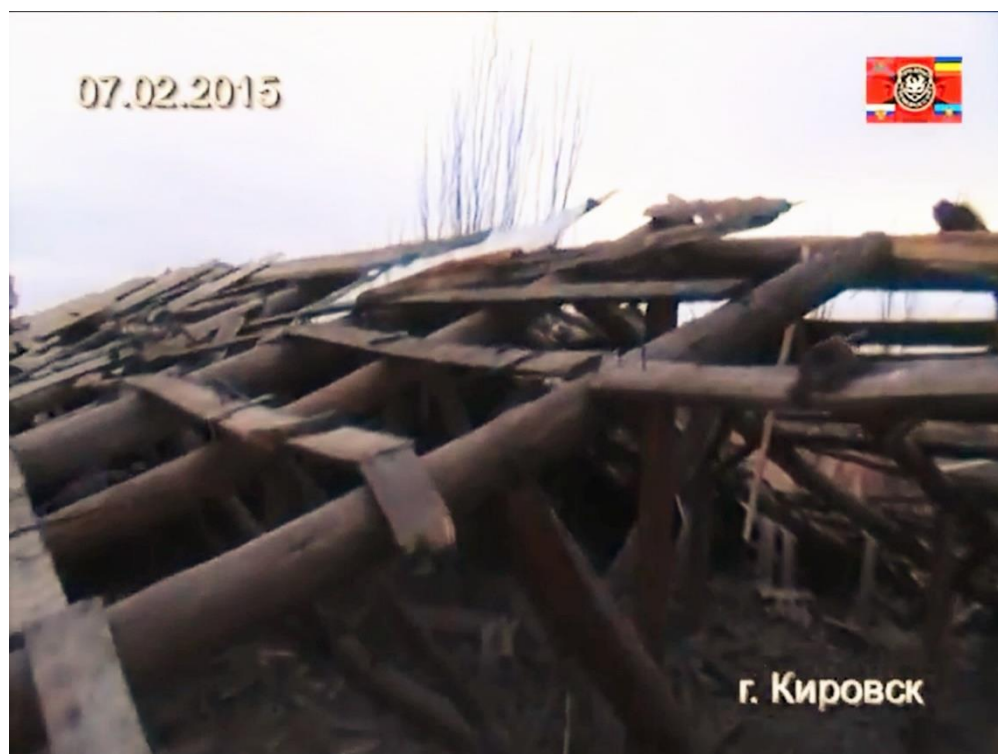
Рис. 12 – Крыша, разрушенная в результате попадания №6 31 .
