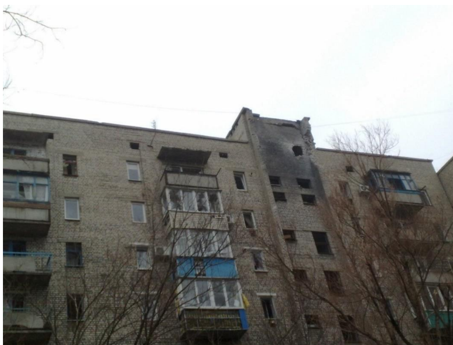
Рис. 21 - Сквозное отверстие в стене дома в результате попадания №9 39 .
