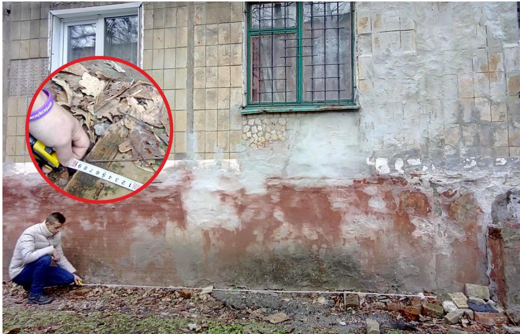
Рис. 21 - Измерение ширины следов от основного потока осколков на стене дома, место попадания № 5 (14.12.2021).
