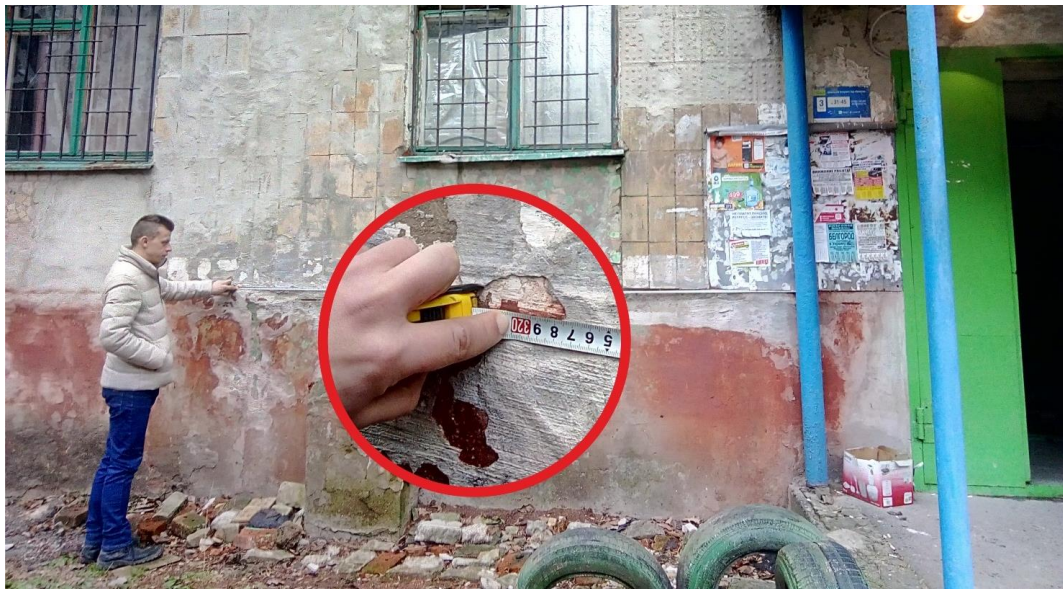
Рис. 20 – Измерение расстояния от проекции центра воронки от взрыва на стену дома до начала следов от осколков на стене дома, место попадания № 5 (14.12.2021).
