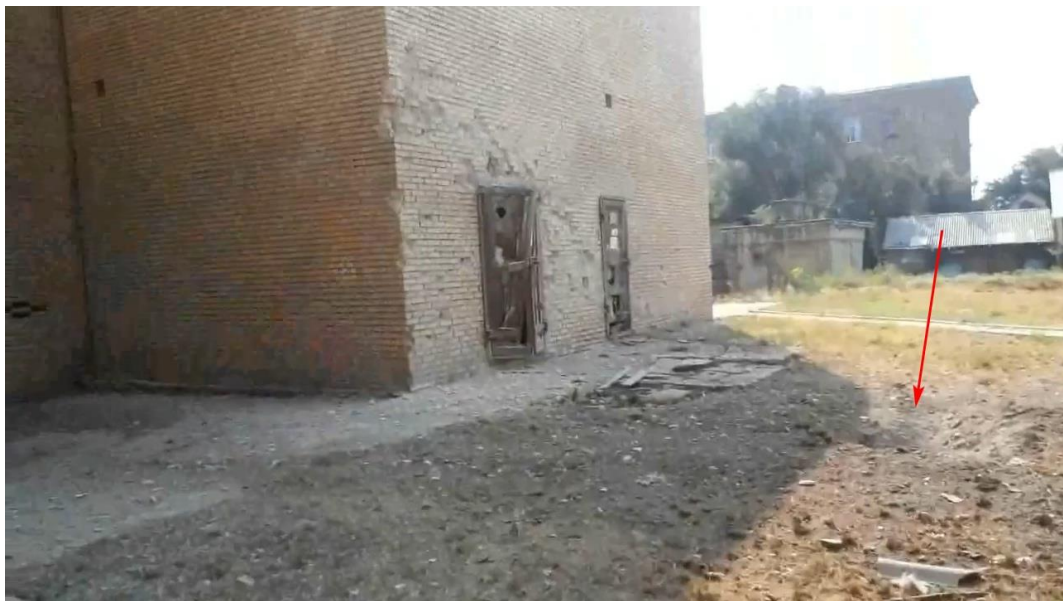
Рис. 17 – След от попадания (№ 8) рядом с электроподстанцией учебного корпуса ДонНТУ № 9 45 .
