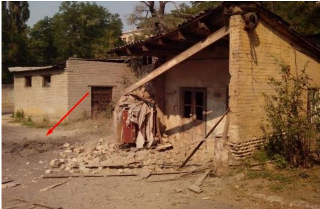
Рис. 9 – Попадание (№ 4) примерно 60 метрах к западу от юго-западного угла учебного корпуса ДонНТУ № 2 38 .
