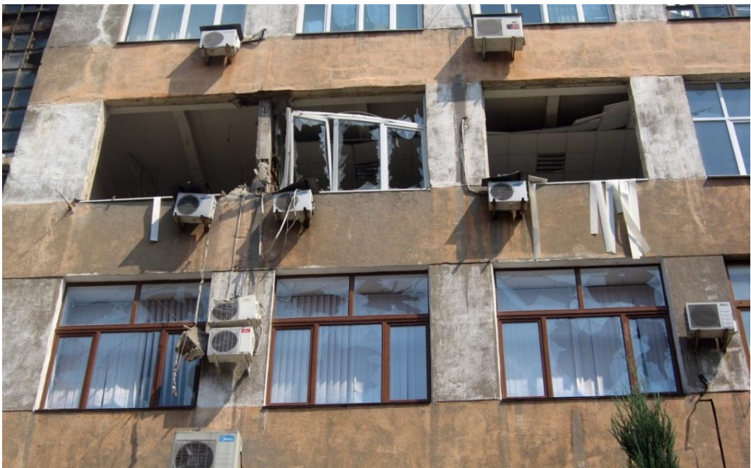
Рис. 11 – Попадание (№ 5) в окно третьего этажа на западной стороне учебного корпуса ДонНТУ № 1 40 .
