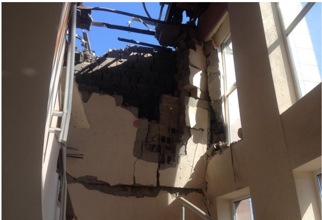
Рис. 19 – Крыша прокуратуры, разрушенная попаданием № 9 47 .
