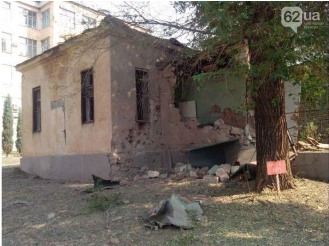
Рис. 14 – Попадание № 6, разрушившее северо-западный угол одноэтажного строения 43 .
