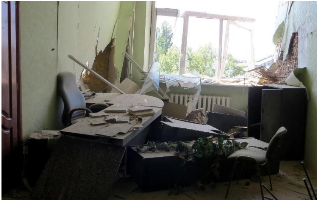
Рис. 12 – Одно из помещений ДонНТУ, разрушенное в результате попадания № 5 41 .
