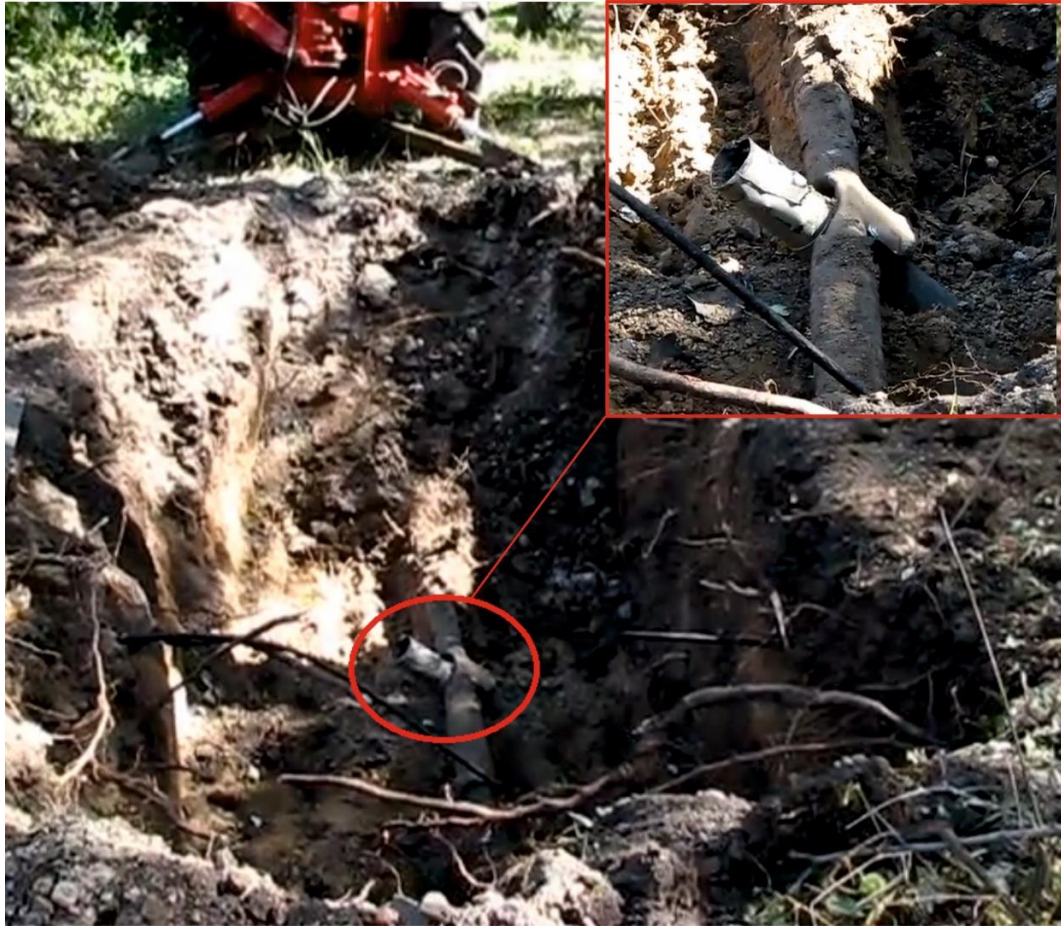
Рис. 12 – Остатки РЧ реактивного снаряда РСЗО в подземном газопроводе в 5 метрах от частного дома по адресу ул. Байдукова, д. 70 30 .
