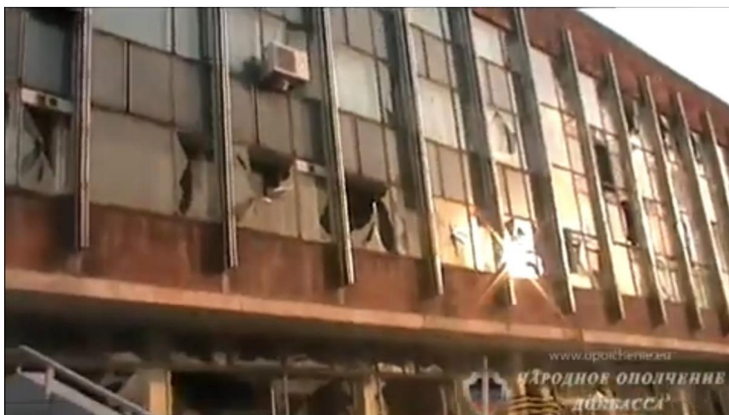
Рис. 20 – Повреждение остекления здания дворца молодёжи «Юность», которое находится по адресу ул. Челюскинцев, д. 189 38 .
